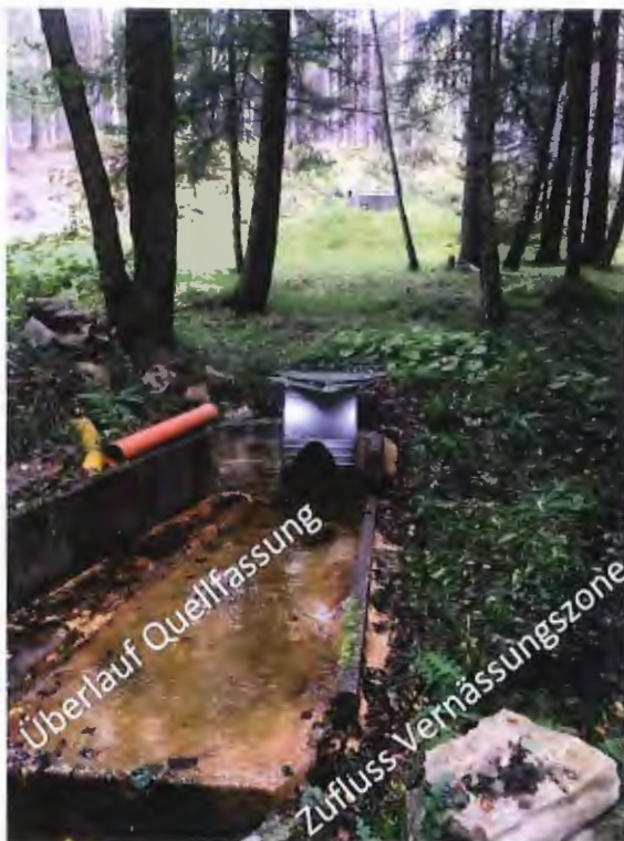
Abbildung 2: Überlauf der Quelfassung mit Sammelschacht im Hintergrund, Blick nach Nordosten
