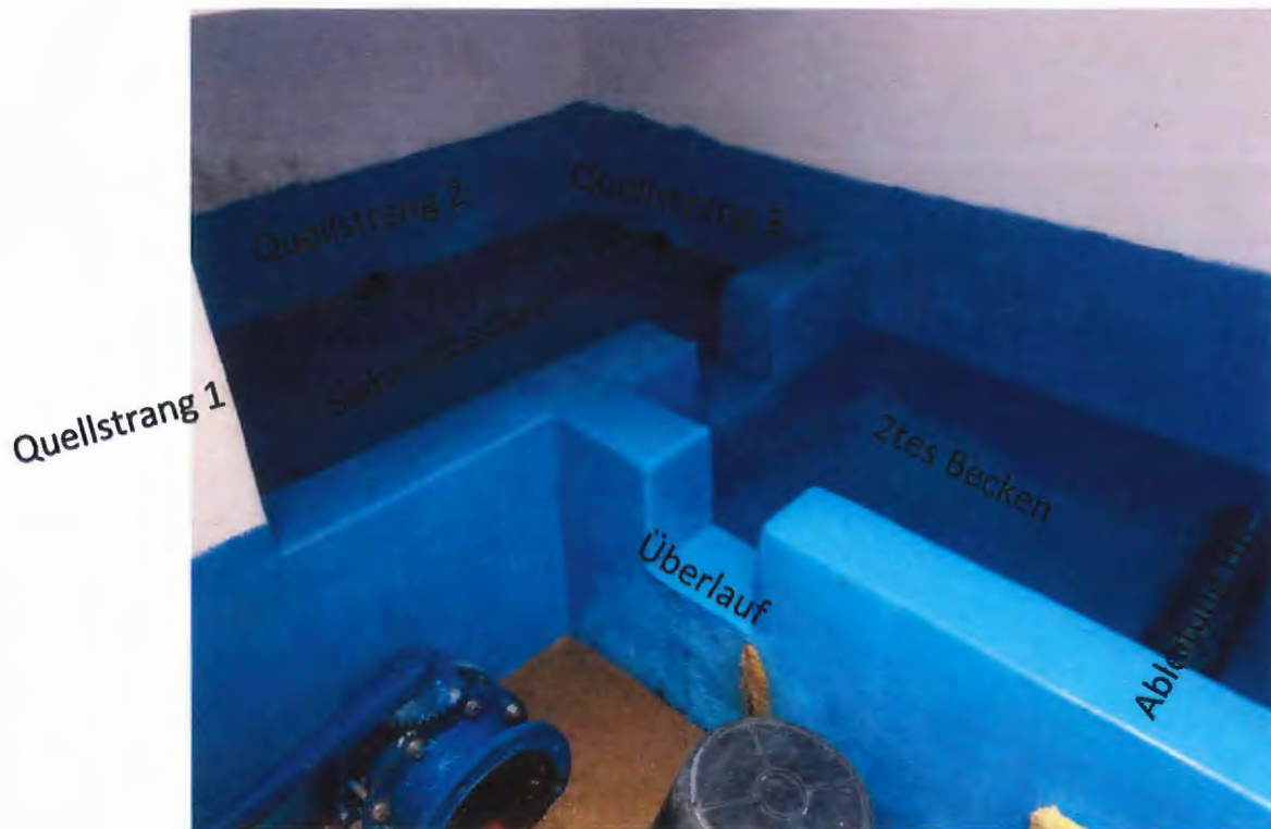
Abbildung 4: Quellsammelschacht im Betriebszustand
